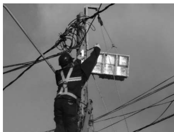
Figura 1- Instalação de medidores inteligentes
