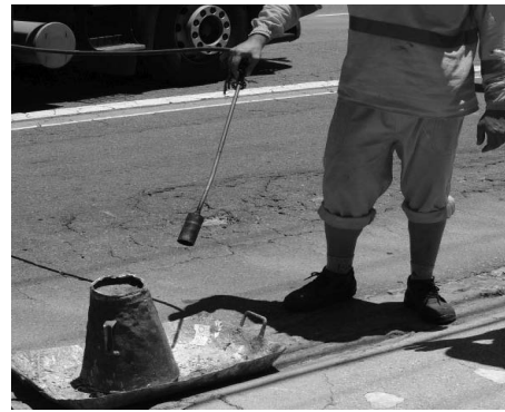
Figura 2. Trabalhador utilizando maçarico sem proteção adequada para o corpo.
