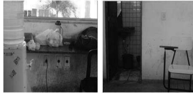
Figura 2 – Inadequações encontradas na guarita A
