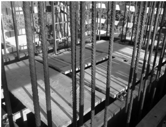
Figura 4 - Assoalhamento aparafusado às consolas, escada e escada com alçapão na plataforma de betonagem. (Nota: tábuas de fecho não estavam colocadas)
