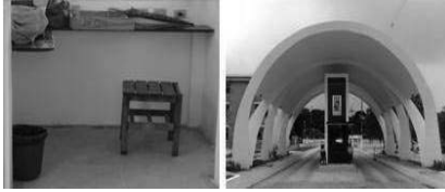
Figura 4 - Inadequações encontradas na guarita D
