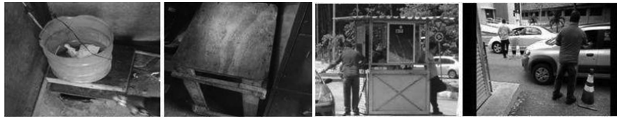
Figura 3 - Inadequações encontradas na guarita B
