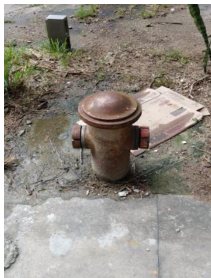
Figura 6. Registro de passeio, entrada da edificação (Autores, 2022).
