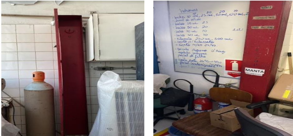
Figura 11. Mantas obstruídas ou em falta de seus abrigos (autores, 2022).
