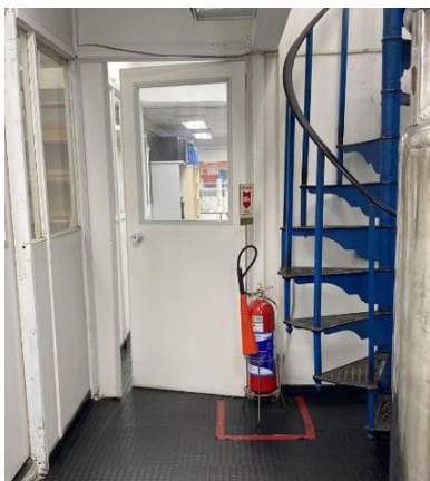
Figura 2: Extintor com demarcação no chão na passagem de transeuntes (Autores, 2022).
