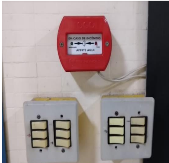
Figura 7. Botoeira de alarme existente (Autores, 2022).
