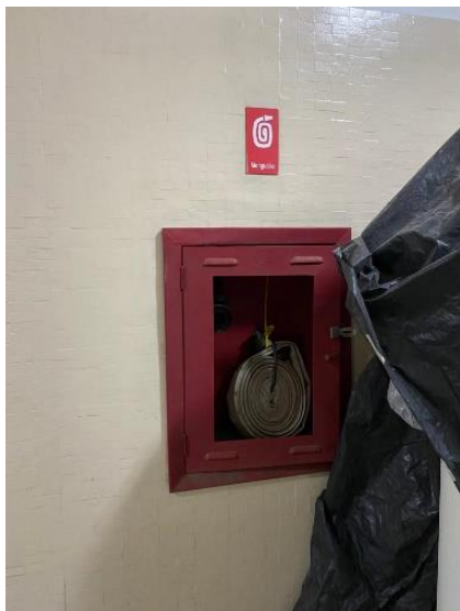
Figura 5. Caixa de hidrante danificada (Autores, 2022).
