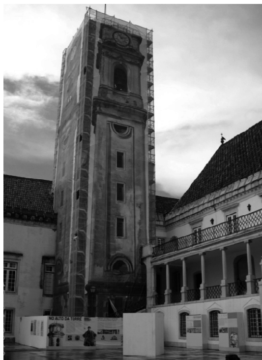
Figura 2 – Estaleiro com andaime e telas cénicas montadas e informação sobre a empreitada (na vedação e envolvente)
