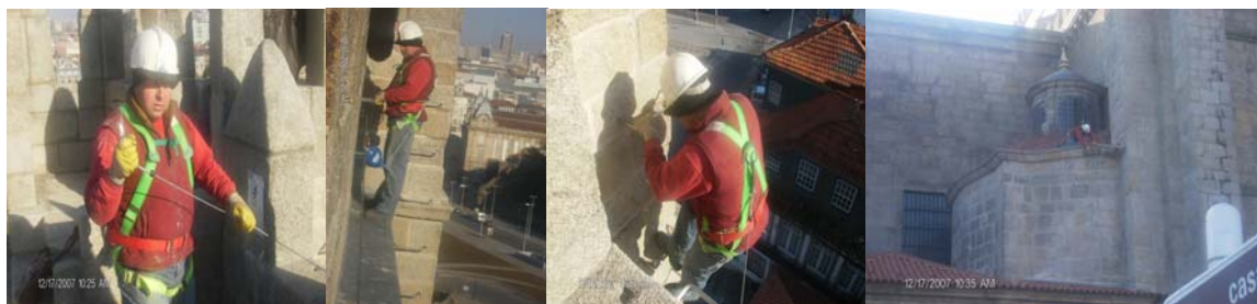
Fig.4: Acesso entre dois níveis de coberturas efectuado por degraus em aço inox cravados na parede da edificação;
