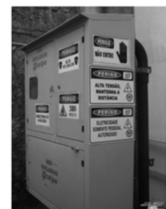
Figura 5 – Quadro Geral devidamente fechado
