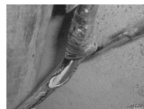
Figura 7 – Os circuitos elétricos não estão protegidos contra impactos mecânicos, umidade e agentes corrosivos.
