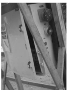
Figura 4 – Quadro geral aberto
