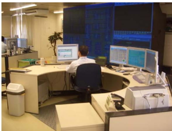
Figura 2 – Situação atual da sala de controle com a substituição dos monitores e painel vídeo wall .
