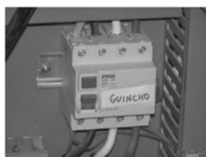
Figura 6 – Quadro de distribuição com seus circuitos identificados
