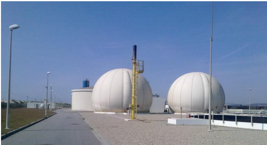
Figura 60 – Reservatórios de biogás e queimador de gás em excesso da ETAR de Espinho.
