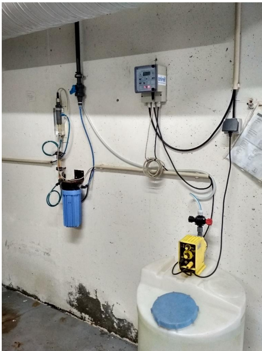
Figura 15 – Sistema de desinfeção por hipoclorito de sódio no reservatório de água para consumo da FEUP.
