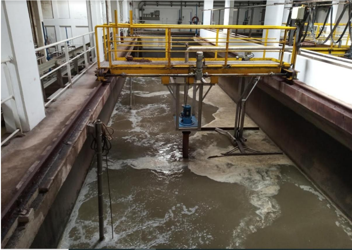
Figura 38 – Desarenador/desengordurador da ETAR do Freixo.
