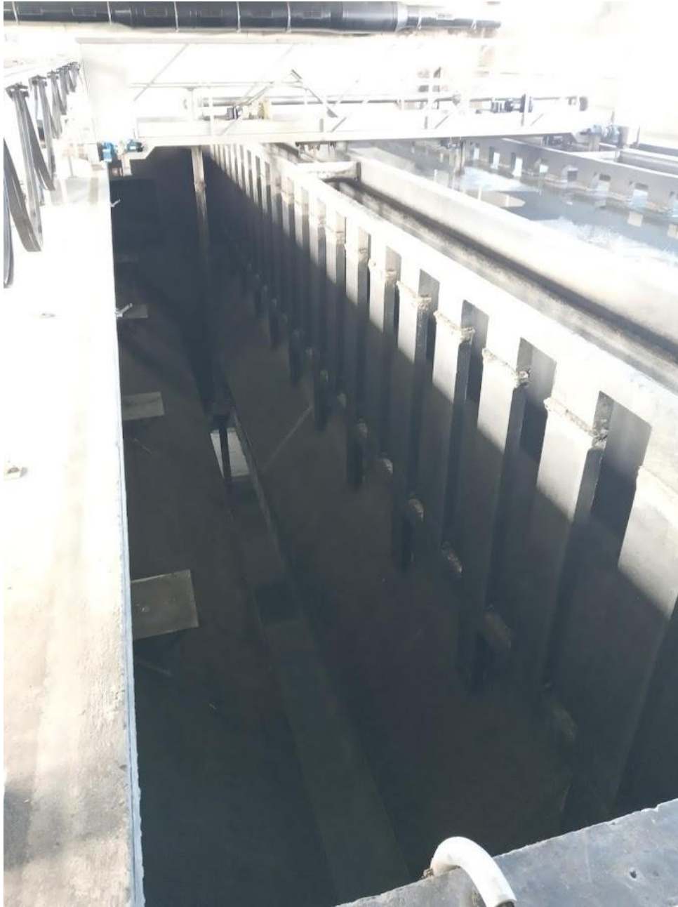
Figura 40 – Desarenador/desengordurador fora de serviço na ETAR do Ave.
