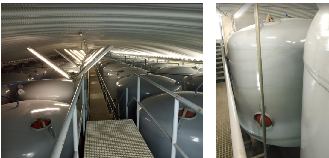
Figura 8 – Sistema de filtração pressurizada da ETA de Lever.
