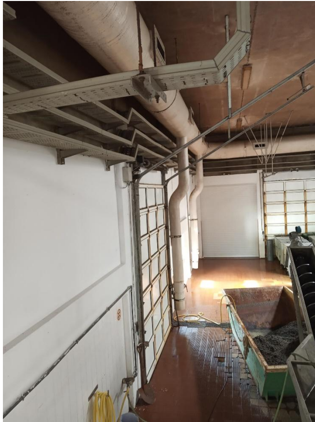
Figura 72 – Conduas de extração do ar: admissão inferior com válvula de regularização e tomadas superiores com grelhas (ETAR do Freixo).
