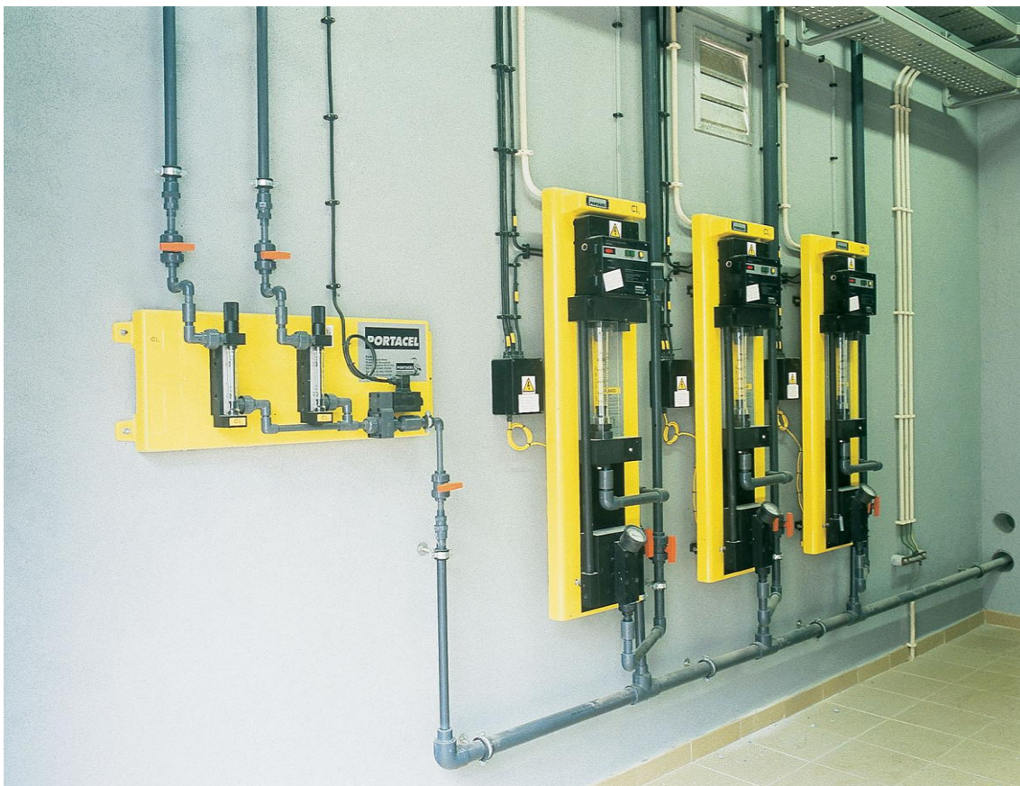
Figura 12 – Sistema de desinfecção final com Cloro na ETA de Lever, à saída da estação (Fonte: www.addp.pt ).
