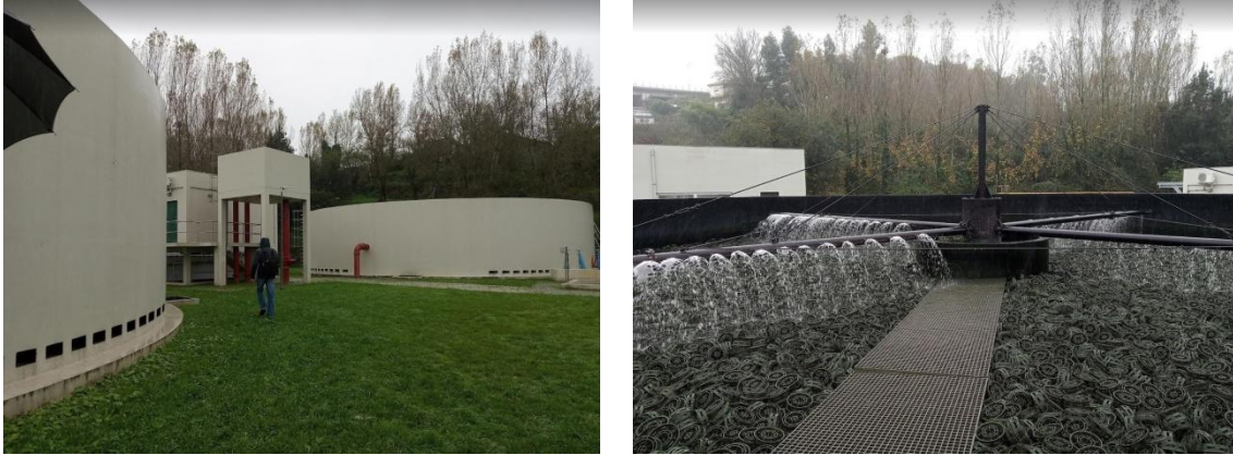
Figura 46 – Leitos percoladores da ETAR do Areinho.
