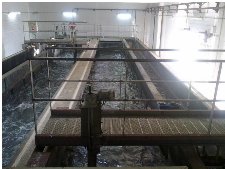
Figura 37 – Desarenador/desengordurador da ETAR de Espinho.
