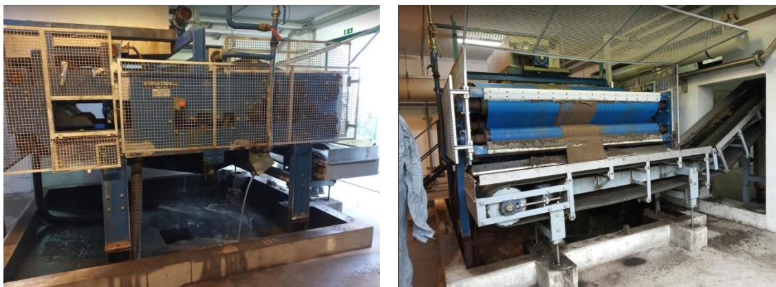
Figura 63 – Filtro de banda para desidratação de lamas na ETAR do Areinho.
