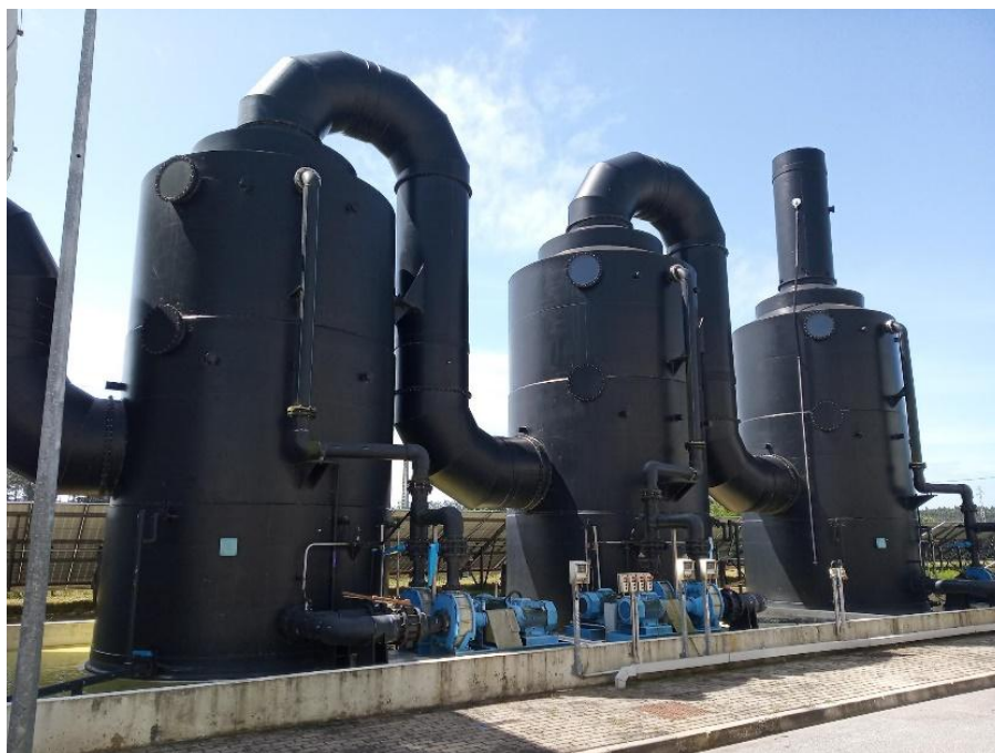
Figura 74 – Sistema de desodorização química da ETAR do Ave, composto por três torres em série onde se processa a absorção ácida, alcalina e oxidante, por esta ordem.
