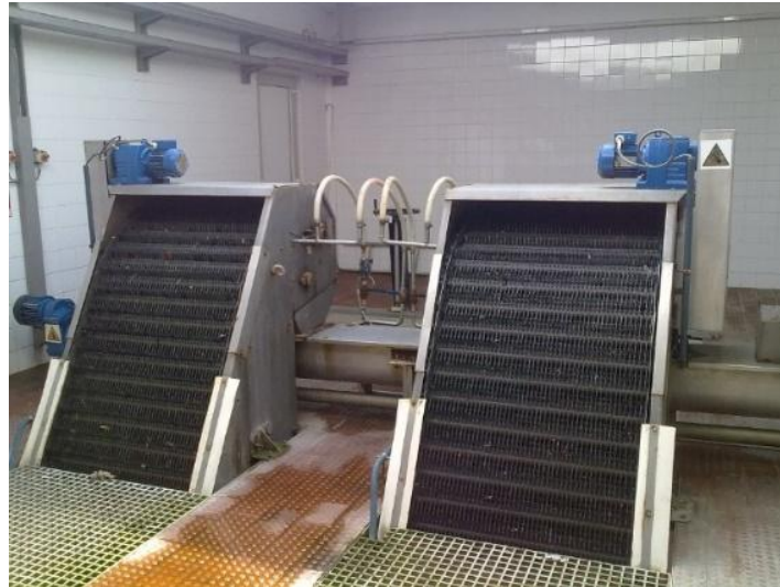
Figura 36 – Tamisadores a jusante da gradagem na ETAR de Espinho.
