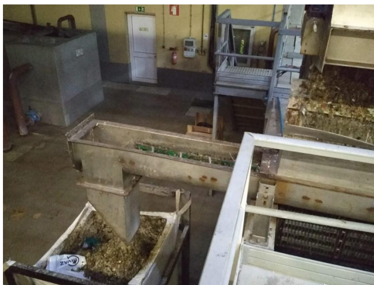
Figura 34 – Remoção de gradados na ETAR de Gaia Litoral.
