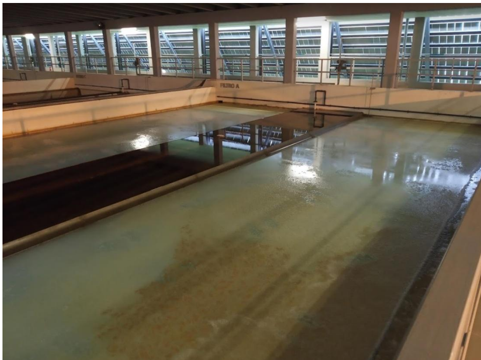
Figura 7 – Unidade de Filtração (e flotação) da ETA de Lever.
