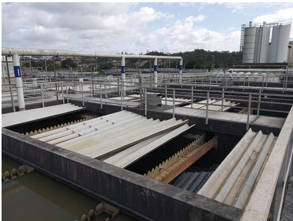
Figura 71 – Coberturas amovíveis, em chapa de PRFV, e condutas de extração do ar na ETAR do Ave.
