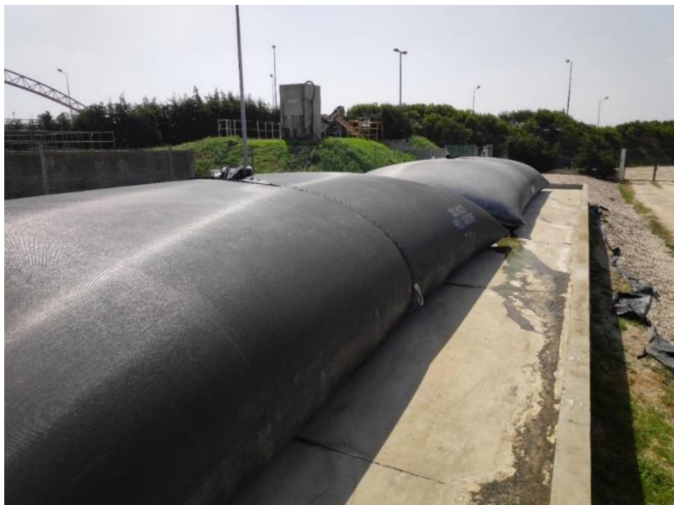
Figura 68 – Unidade Geotube® em funcionamento da ETAR na Figueira da Foz sobre uma plataforma construída para a estrutura (Caldas, 2021).
