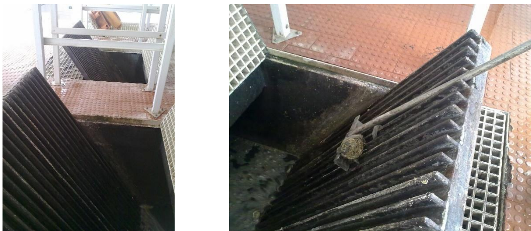
Figura 33 – Grades para limpeza manual na ETAR de Espinho.
