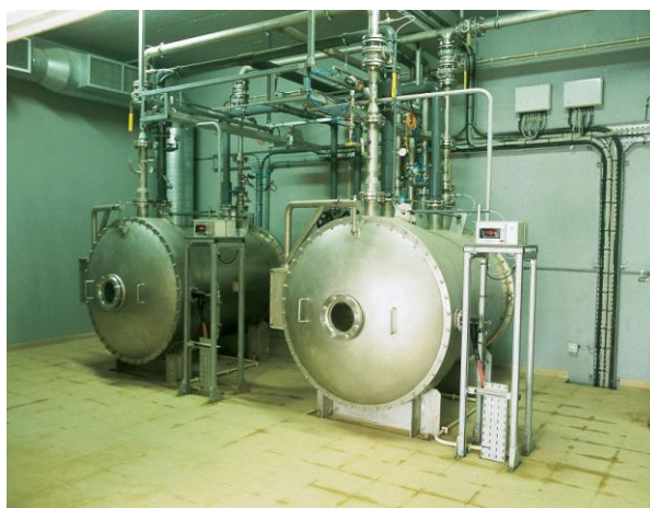
Figura 17 – Pré-oxidação da água captada na ETA de Lever (Fonte: www.addp.pt ).
