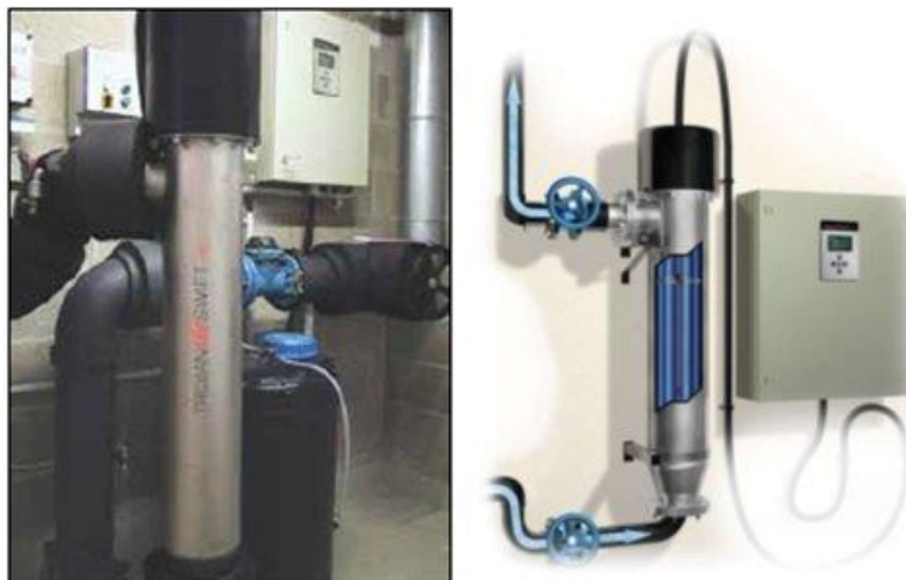
Figura 18 – Desinfecção por UV na ETA de Gondomar (Fonte: www.cm-guimarães.pt ).
