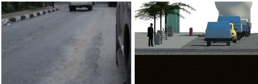
Figura 5: Pavimento urbano: a) resultados da inspeção visual (fotografia); b) resultados da inspeção visual (modelo BIM).
